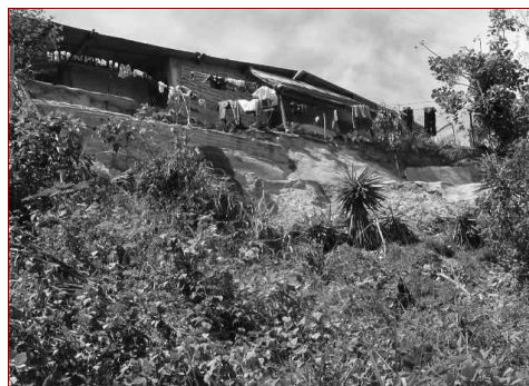
Deslizamiento debajo de las casas de Santo Tomás
