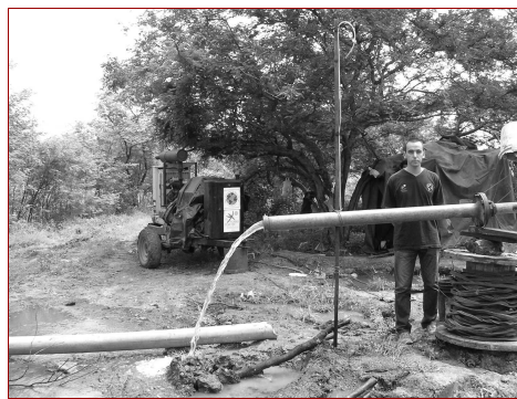
Aforo de un pozo. Piedras blancas
