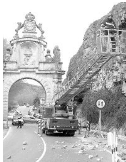
Desprendimientos de rocas ocurridos el 23 de abril de 2005, también en las proximidades del Santuario de La Fuencisla. Fuente: El Adelantado de Segovia.
