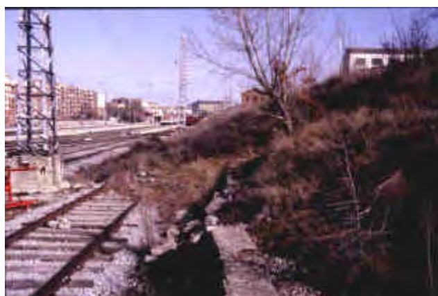
Pie y frente del deslizamiento rotacional invadiendo la vía de acceso al almacén de máquinas, y combando y rompiendo el murete de contención.
