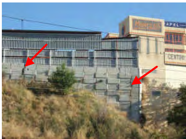
Agrietamientos y desencajamientos de los muros y módulos de la cimentación de edificios y naves en las inmediaciones del deslizamiento.
