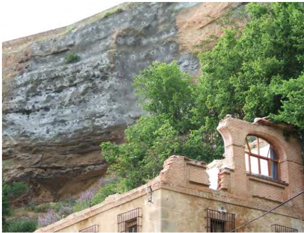
Detalle del bulonado y gunitado elegido como solución técnica para la fijación de la placa de roca contigua a la zona desprendida.
