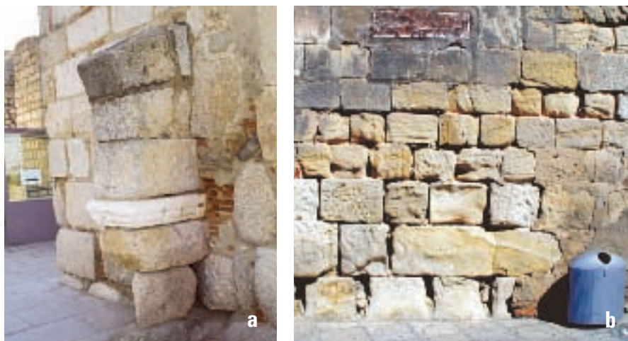
Figura 8. Deterioro de los materiales de construcción: (a) erosión del granito, pérdida de material en los ladrillos y desprendimiento del mortero en la alcazaba de Mérida (Badajoz); (b) erosión diferencial de la piedra siguiendo su estratificación original, favorecida por la pérdida de los morteros de revestimiento y de junta aplicados sobre el paramento, que presentan, además, un elevado grado de enmugrecimiento (Soria).
