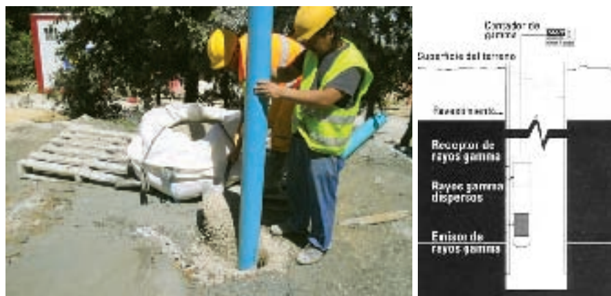
Figura 13. Entubación de un sondeo realizado a rotoperación, con PVC ranurado y colocación de macizo de grava (para filtro de finos). Por el interior del PVC se puede hacer descender una sonda para testificación radiactiva del sondeo (imagen de la derecha).
