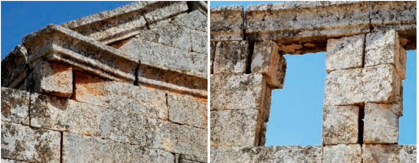
Figuras 9 y 10. Desperfectos originados en el paramento, provocados por un terremoto?
