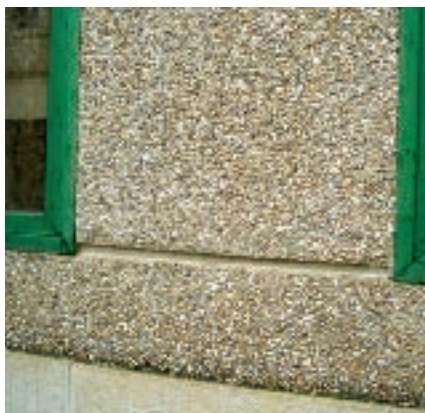
Figura 10. Fachada con un acabado con mortero monocapa a la piedra proyectada.
