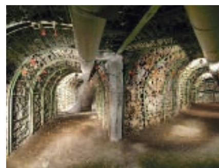
Figura 21. Una vez estabilizado el derrumbe inicial se procedió a continuar con la excavación de los primeros metros de ramal. En la foto puede apreciarse, una vez finalizado, el entronque entre la galería principal y el ramal. El túnel de la izquierda conduce a la piscina de agua caliente y al acantilado antiguo. El ramal, túnel de la derecha, tras la curva que se ve al fondo, gira 45° y llega al dique donde mana la Fuente Santa. El pórtico que separa galería y ramal fue una de las partes más complicadas de la obra. Se resolvió construyendo un marco rectangular, hecho con vigas de hierro, que se puede observar en el techo y que es donde se apoyan las cerchas de ambos túneles. Esas mismas vigas, en los tramos verticales y en el suelo, se hormigonaron tal y como puede apreciarse en el pilar del centro de la foto.
