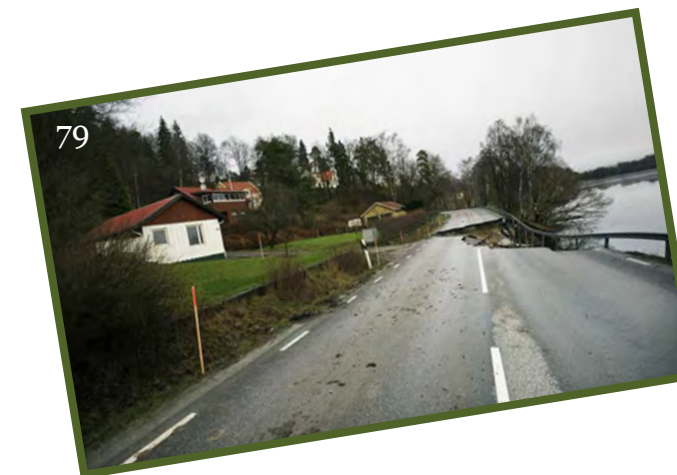
Inundación en Gothenburg y colapso de la carretera.
