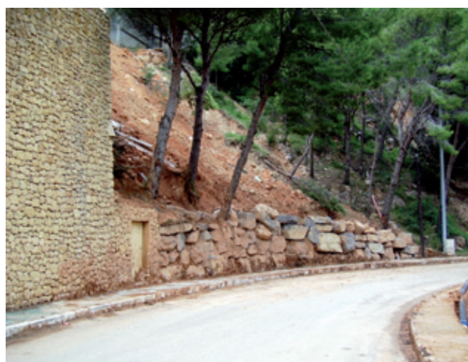
Figura 1.B. Vista lateral del mismo deslizamiento en el que se puede apreciar cómo en la zona del talud donde no se realizó, la escollera no deslizó (derecha).
