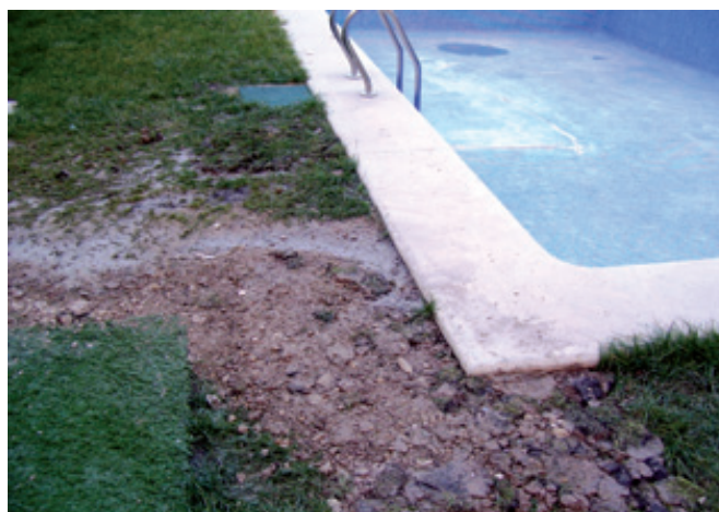
Figura 3.D. Reparación de zona conflictiva junto a vaso de la piscina, en el cual se detectan grietas transversales y longitudinales.
