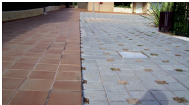
Figura 3.B. Hundimiento del firme del vial de una urbanización, donde no se realizó una compactación adecuada. Se puede apreciar el colapso en dos zonas. En una zona más anaranjada (centro de la figura) y en el encuentro del pavimento con el muro de las viviendas (izquierda), donde se aprecia la sinuosidad del mismo.
