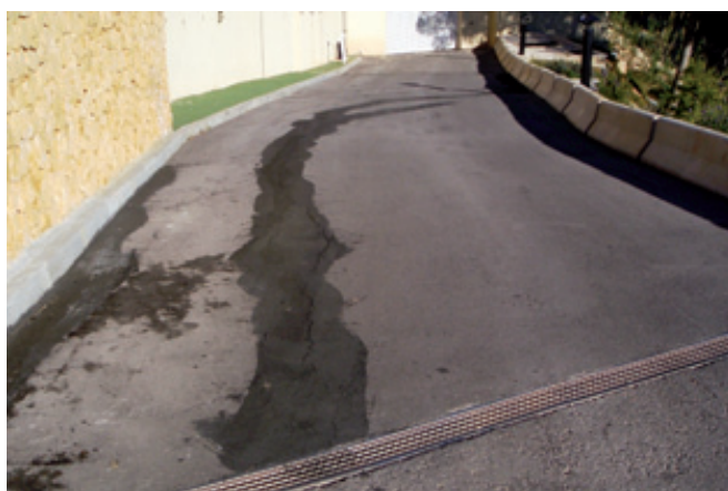
Figura 1.E. Grietas en vial de una urbanización junto al talud que deslizó por descabezamiento de la base del mismo.
