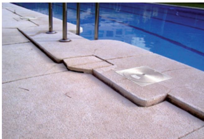
Figura 3.C. Colapso de 7-8 centímetros del bordillo de una piscina, provocado por un lavado de finos producido por el agua proveniente del riego del jardín o por la fuga del vaso de la piscina.
