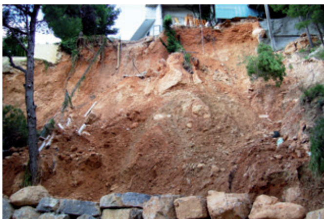
Figura 1.A. Deslizamiento de un talud limo-arcilloso en el que, en su parte superior, se ubica una vivienda cuya cimentación queda en voladizo, y en su parte inferior se emplazó un muro de escollera para contener el talud y realizar la carretera, lo que produjo un cambio en las condiciones del mismo y el consiguiente deslizamiento al superar la pendiente del talud, descabezado el ángulo crítico.
