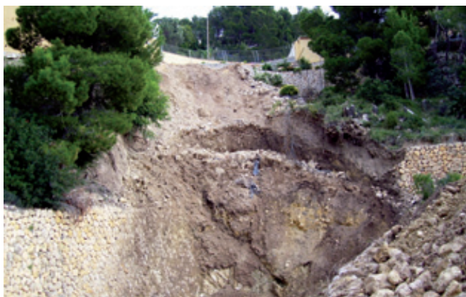
Figura 1.C. Deslizamiento de un talud, provocado por fuertes lluvias, en el que se aprecia rotura en cuña, con vivienda emplazada en el margen superior izquierdo.
