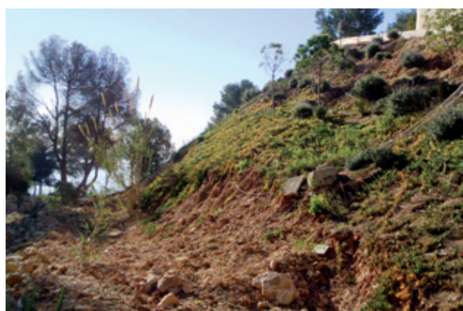
Figura 1.F. Descabezamiento de un talud (zona sin vegetación) para la realización de un encauzamiento, que produjo las anomalías en el vial de la figura 1.E.
