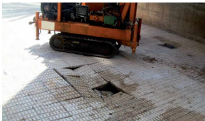
Figura 3.A. Máquina de sondeos desplazándose por un vial de una urbanización, donde se puede apreciar un colapso o hundimiento del firme por un lavado de finos.
