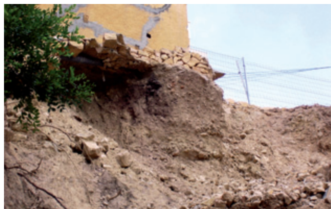
Figura 1.D. Cimentación en voladizo de una vivienda en el deslizamiento de la figura 1.C.
