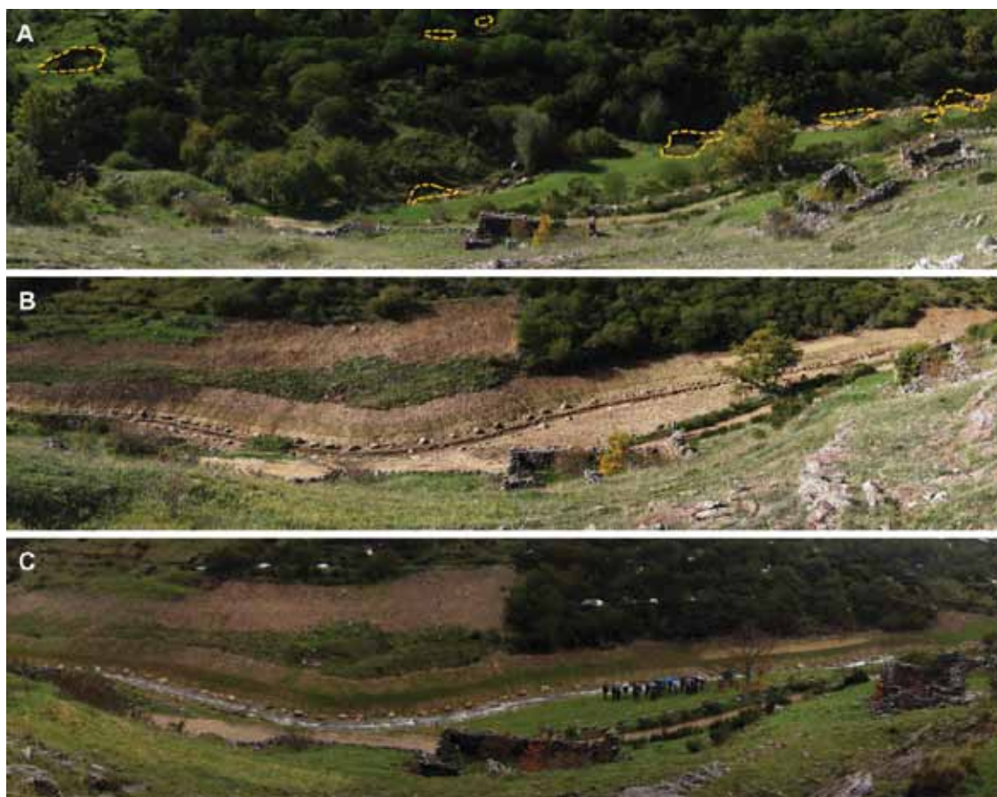
Fig. 6. Apariencia del área del arroyo de Alcedo antes y después de los trabajos ejecutados. A. Situación previa, con la presencia de dolinas de colapso (octubre 2013); B. Situación al finalizar los trabajos (octubre 2015); C. Apariencia actual, donde se aprecia el inicio del proceso de revegetación (abril 2016)
