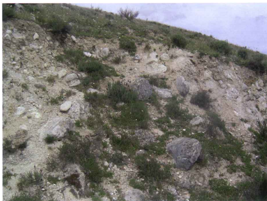
Figura 14. Talud excavado en un cono de deyección cuaternario, con bloques polimícticos y matriz arenosa. El Molar.
